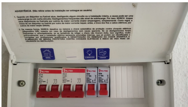
Figura 6: Distribuição dos disjuntores no interior do quadro.
